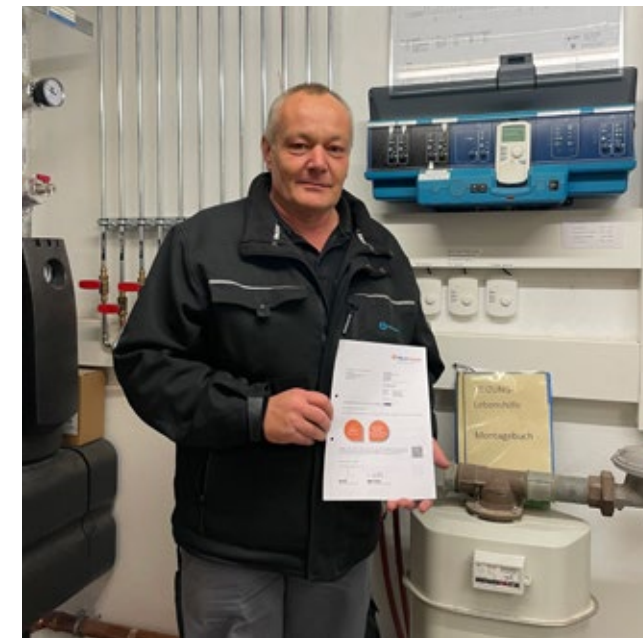
Torsten Glatz, Teamleiter der Haustechnik bei der Lebenshilfe Bad Gandersheim-Seesen e.V., neben dem Gaszähler im Haupthaus. In der Hand hält er eine Energieabrechnung, die erfreulicherweise ein Guthaben ausweist.
